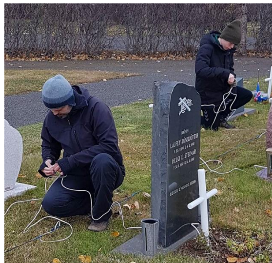
Koppling av korsen till elnätet
